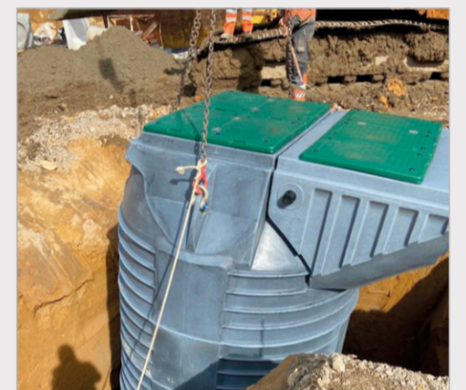
Impianto di SOLLEVAMENTO Lifting system
