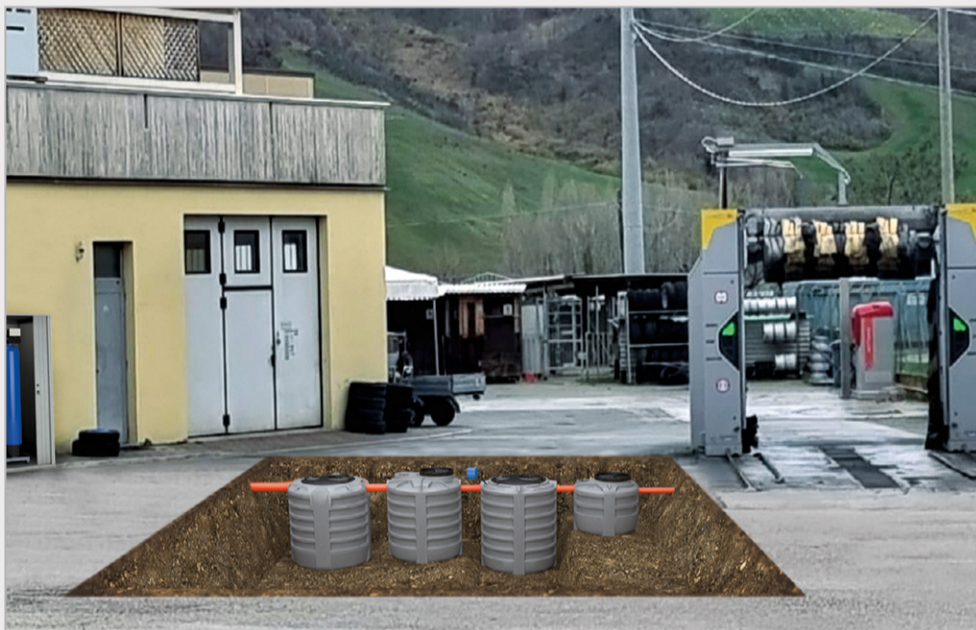
Impianto di AUTOLAVAGGIO Car washing installation
