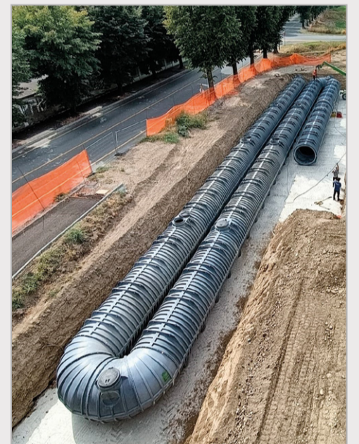
impianto di laminazione Lamination system
